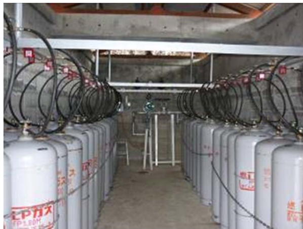
ボンベ庫内部
