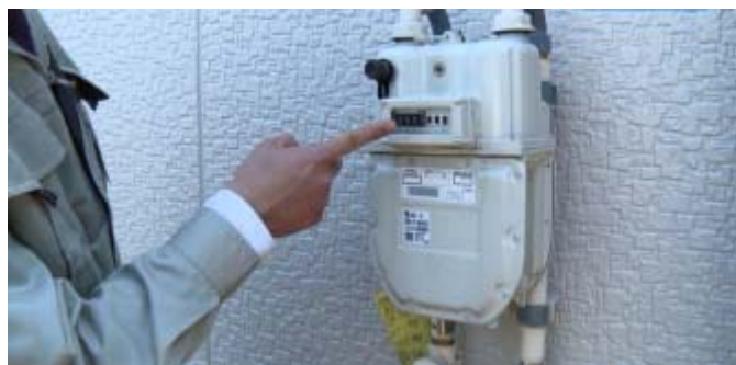
■ マイコンメーターによる漏えい確認
