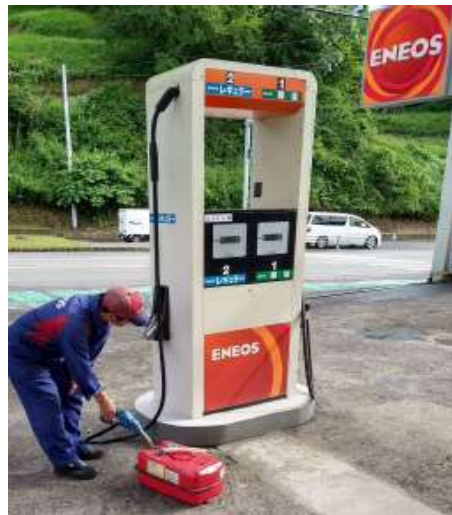
自家発電機稼働により燃料供給継続する住民拠点SS
