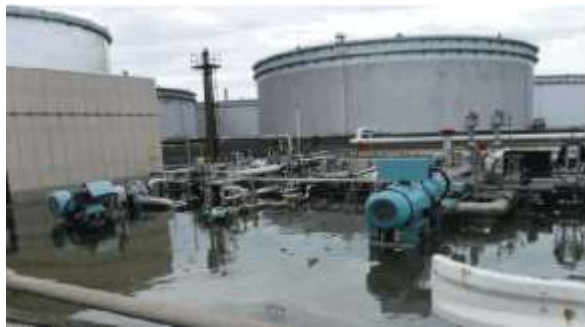
冠水した製油所敷地
