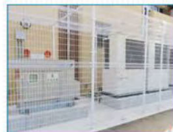
GHPと非常用発電機を導入（日新小学校）
