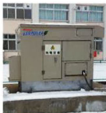
非常用発電機
