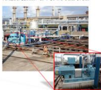
製油所の排水設備の増強 特別警報級の大雨等の発生時における 製油所機能の低下・停止を防ぐために、 排水処理能力を増強。
