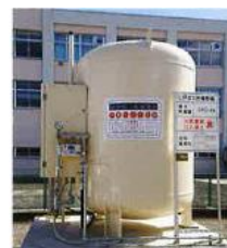
LPガスタンク
