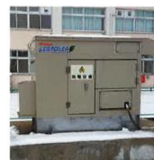
非常用発電機
