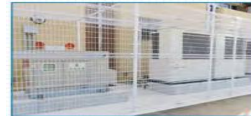
GHPと非常用発電機を導入（日新小学校）
