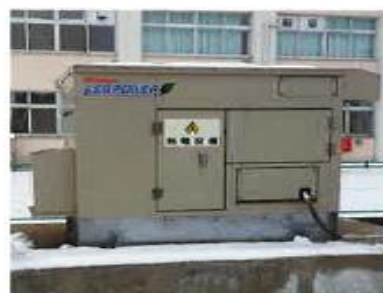
非常用発電機
