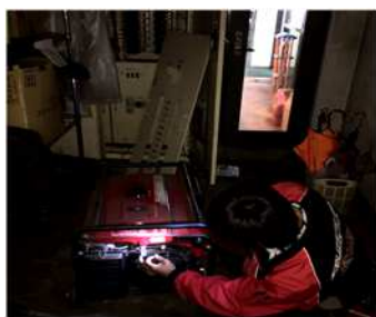
自家発電機により営業している中核SS (熊本県阿蘇市/2016.4.18撮影)
