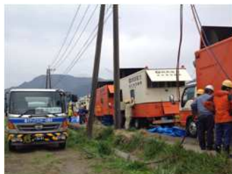
停電地域において「移動電源車」に タンクローリーから軽油を供給 (熊本県阿蘇市/2016.4.18撮影)
