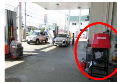
停電直後から、自家発電機を稼働させて給油を継続した中核SS (北海道札幌市/2018.9.6撮影)
