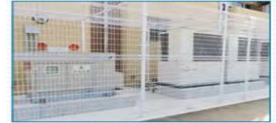
GHPと非常用発電機を導入（日新小学校）
