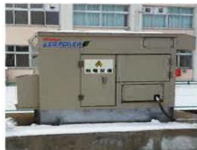
非常用発電機
