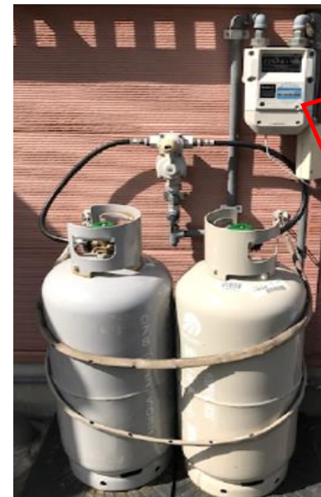
一般家庭などでの設置状況
