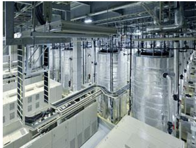
電解液タンク・電力変換装置
