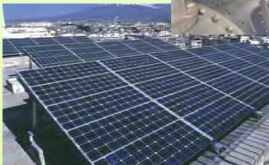
【太陽光発電設備】
