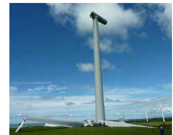
苫前グリーンヒルウインドパーク(北海道)の 風車落下事故(平成25年9月)
