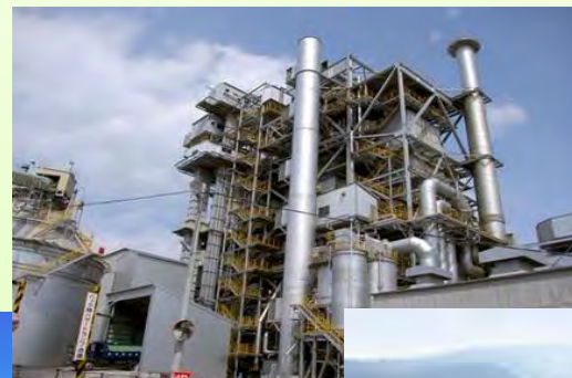
【バイオマス発電設備】
