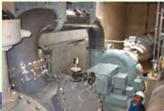
【水力発電設備】
