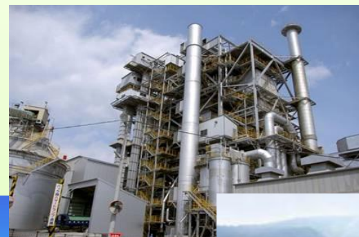
【バイオマス発電設備】
