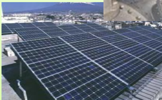
【太陽光発電設備】
