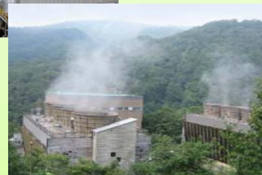
【地熱発電設備】
