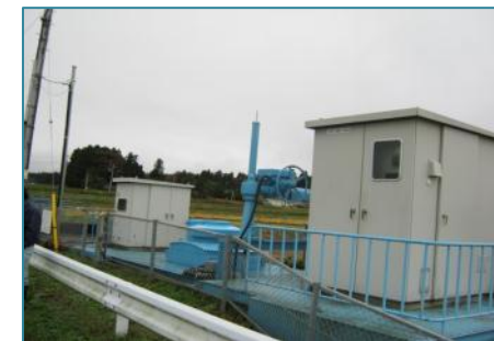
（農業用水を活用した小水力発電） 「百村第二発電所」（栃木県）
