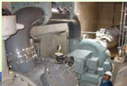
【水力発電設備】
