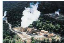
澄川地熱発電所 出力 50,000 kW
