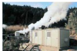
霧島国際ホテル地熱発電所 出力 100 kW
