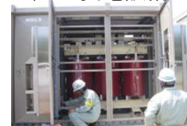
トランス・変電設備
