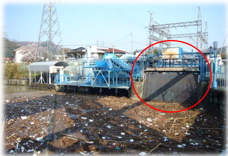
取水口に設置の塵芥除けスクリーン ゴミ付着状況※自動除塵機により除去
