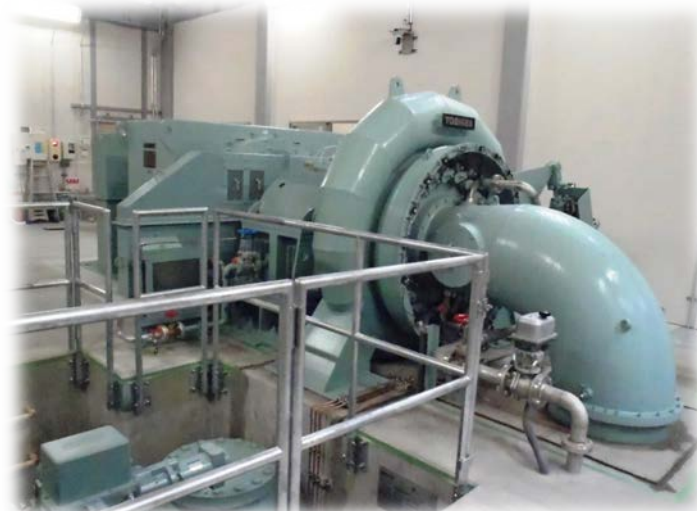
平成27年3月にリプレイスした水車・発電機 1,600kW
