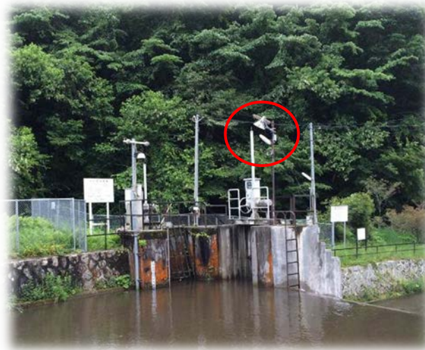
出水時の状況等を確認する監視カメラ
