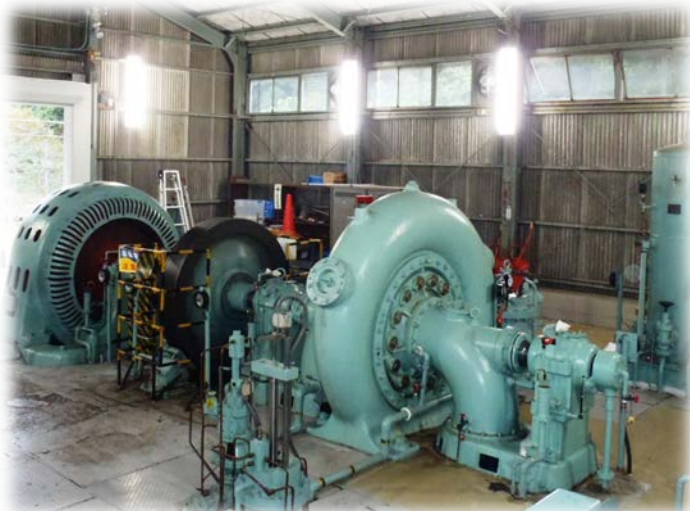
大正11年11月に運転を開始した水車・発電機 1,400kW
