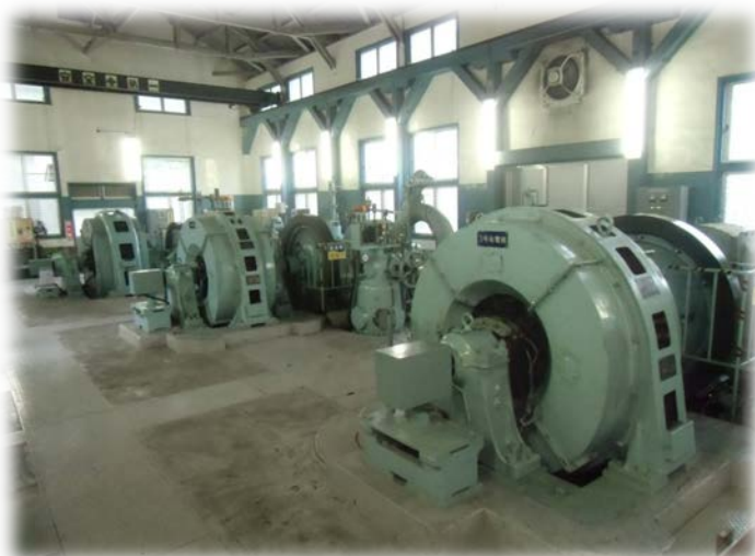
昭和2年1月に運転を開始した水車・発電機 2,900kW
