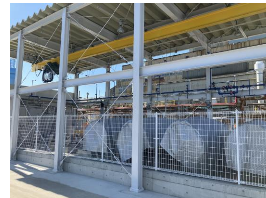
試験に用いたアンモニアの貯蔵タンク
