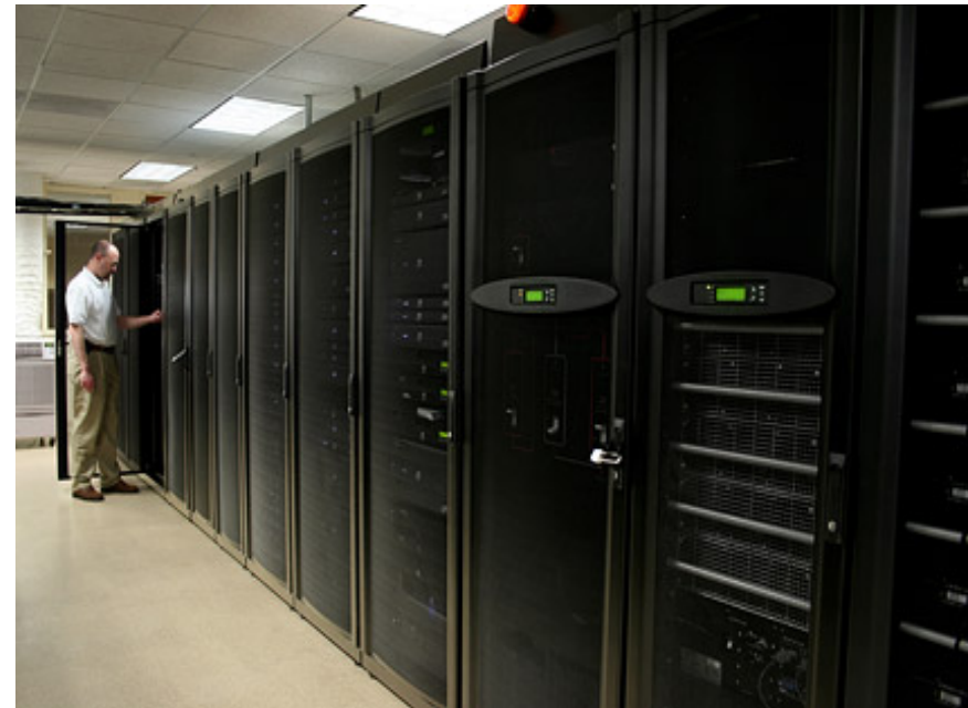
データセンター内部（例）
