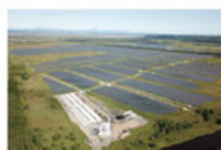
すずらん釧路町太陽光発電所
