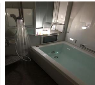
給湯により入浴が可能
