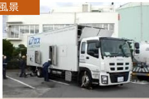
搭載された発電機から電力供給
