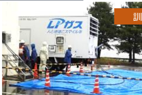
電源車を基地の受電設備に接続
