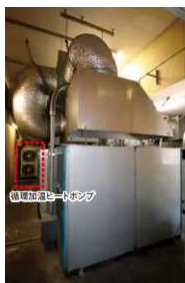
コンプレッサー室（奥HP、右手前コンプレッサー）
