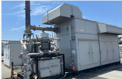
水素対応設備（例：水素混焼ガスコジェネ）※1
