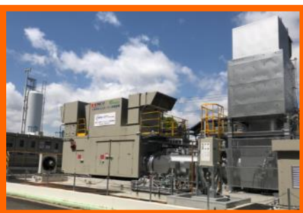
水素CGS エネルギーセンター
