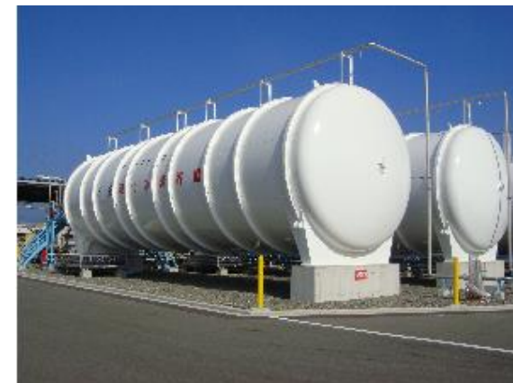
液化水素貯蔵タンク
