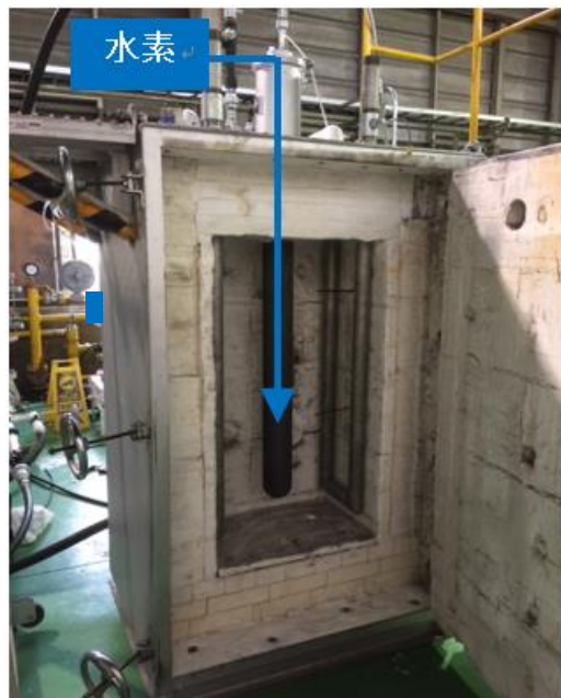
東邦ガス 水素燃焼試験場
