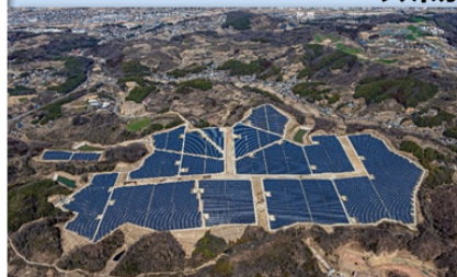
安中市太陽光発電所 (群馬県)
