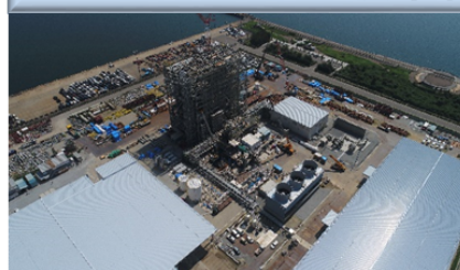
伏木万葉埠頭バイオマス発電所 (富山県)
