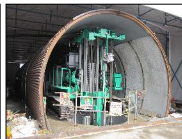
噴射・吸引設備
