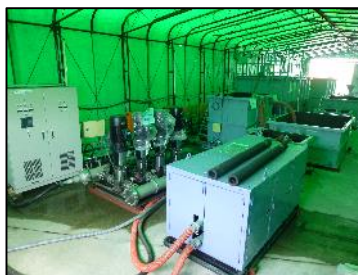
塩水リユース設備
