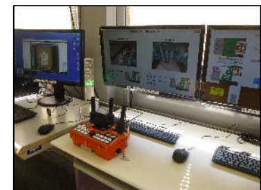
遠隔操作設備
