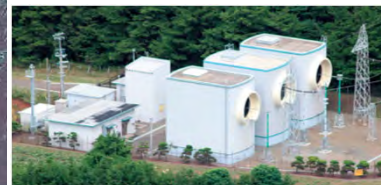
古川ケーブルヘッド
