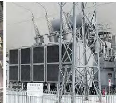
②変換用変圧器 サイリスタバルブに適した電圧に調整
