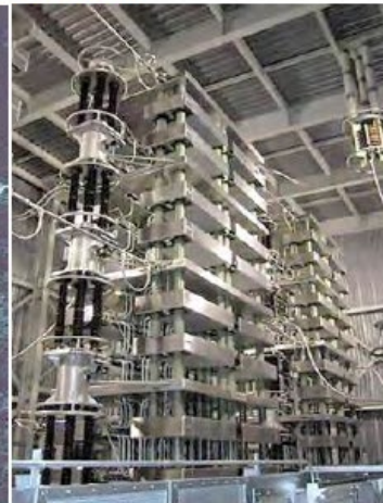
①変換器(サイリスタバルブ) 交直変換装置
