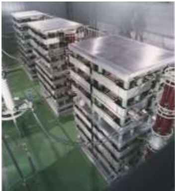
250kV 2800A サイリスタバルブ (紀伊水道 2極)
