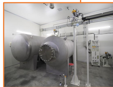
合成ガス / バッファータンク・昇圧装置
