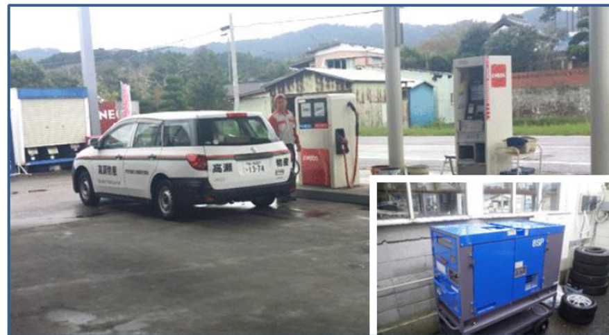
住民拠点SSでの自家発電機による給油(鴨川市) (9/9朝から電力復旧までの9日間、自家発で給油継続)
