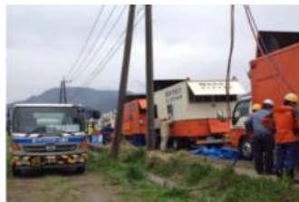
電源車に対する燃料供給 (出所)資源エネルギー庁
