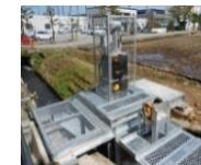
小水力発電施設
