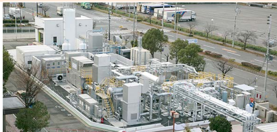
水素燃焼ガスタービン発電プラント
