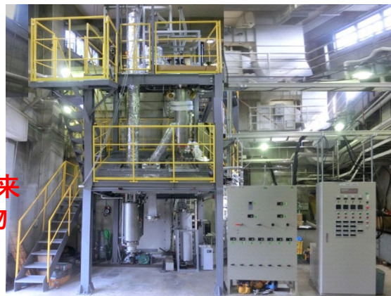
循環流動層試験装置（バイオマス発電）
