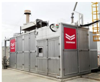
②ガス化発電炉
