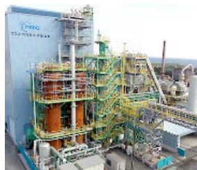
COURSE50試験高炉
