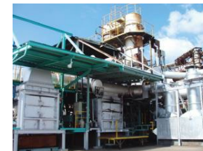
電池の無害化 処理工程
