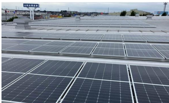
群馬工場に設置した太陽光パネル
