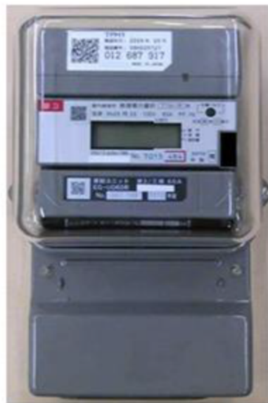
(関西電力・九州電力)
