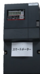
スマートメーター
