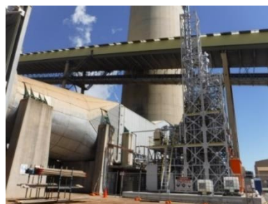
CO2回収設備
