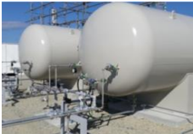
水素貯蔵タンク (400Nm 3 )
