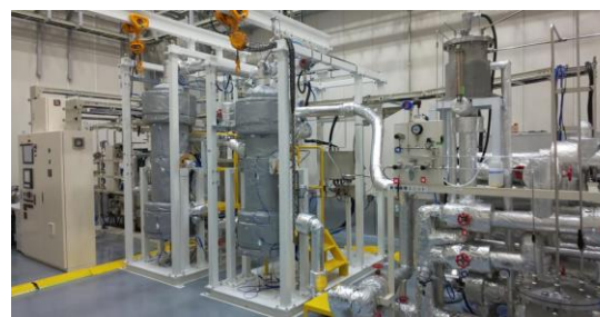
メタネーション設備
