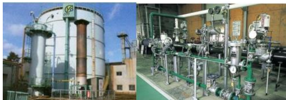
長岡中央浄化センター ガスタンク
