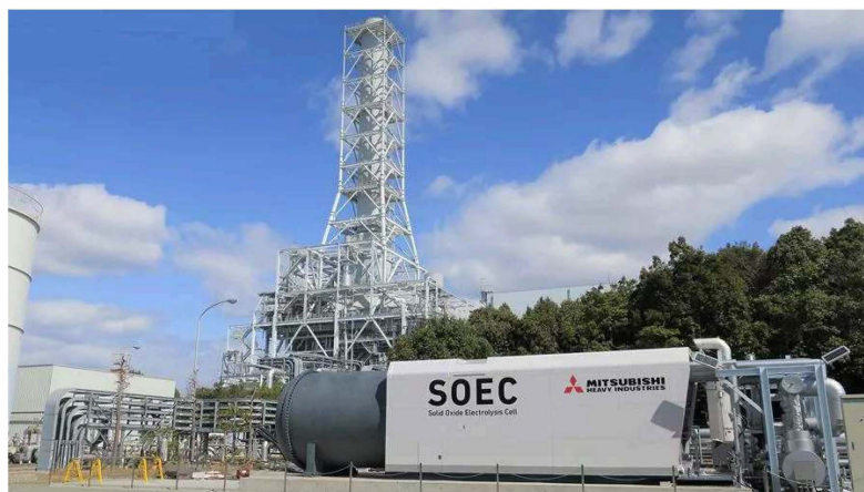
400kW容量のSOECデモ機
