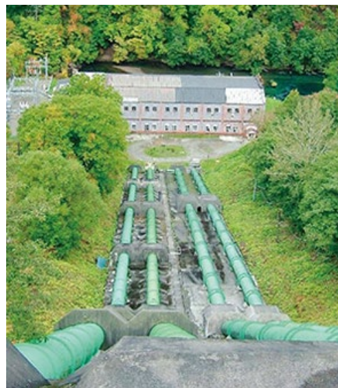
王子製紙千歳第一水力発電所
