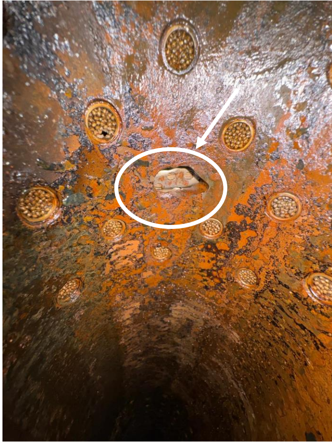
出砂対策装置内部 エロージョン
