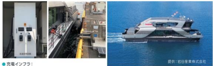
● 充電インフラ： 南港発電所に設置されている船舶用充電設備
