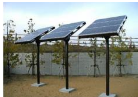
実証予定の既存発電設備（一部）
