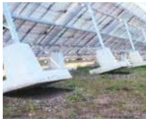
強風で架台が持ち上がり傾き
