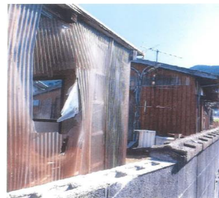
破損した民家
