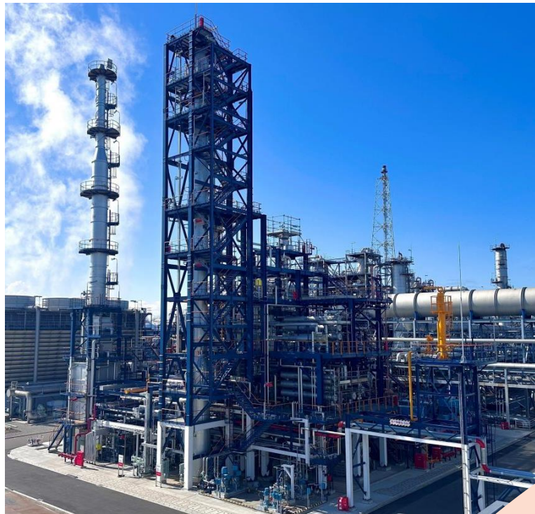
日本初のSAF量産プラント (コスモ石油 堺製油所)
