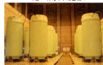
乾式貯蔵施設
